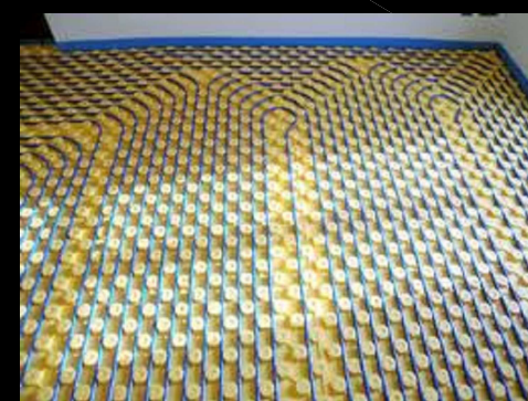
Impianto di riscaldamento a pavimento radiante termoautonomo
